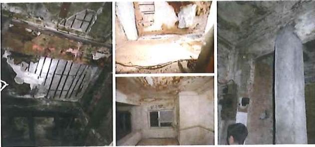
建築物內部現況，普遍出現失修現象及結構欠佳
